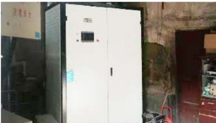
项目名称: 南阳市镇平县瑞泰大酒店 项目性质: 6000平方供暖 设备选型: 冷凝式模块炉500KW 1台
