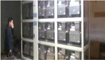
项目名称: 安阳内黄县中州国际饭店及格林豪泰酒店及住宅区 项目性质: 单供暖 60000平方米 设备选型: 冷凝式模块炉2400KW1台
