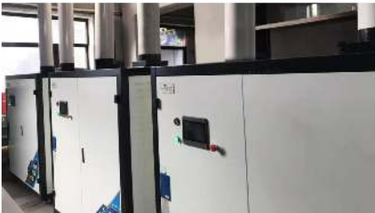
项目名称: 晋中平遥县麟麟阁大酒店 项目性质: 12000平方供暖+生活用水 设备选型: 低氮冷凝式模块炉400KW3台并联
