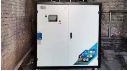
项目名称: 廊坊市葛渔城镇政府 项目性质: 供暖3000平方 设备选型: 低氮冷凝式模块炉300KW 1台
