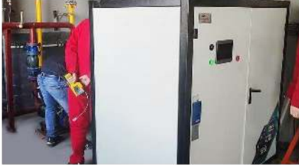
项目名称: 白银市公安局交通支队机动车驾驶员考试场 项目性质: 3000平方左右供暖 设备选型: 低氮冷凝式模块炉300KW 1台
