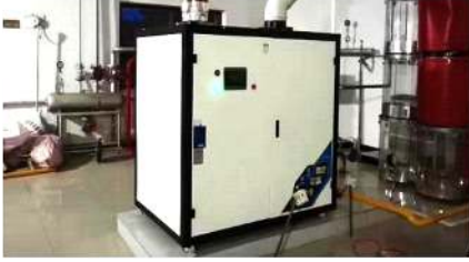
项目名称: 廊坊市安次区消防大队 项目性质: 供暖3000平方 设备选型: 改造低氮冷凝式模块炉300KW 1台
