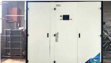
项目名称: 廊坊市安次区杨税务乡廊坊市民兵预备役训练基地 项目性质: 单供暖 6000平方米 设备选型: 低氮模块炉700KW1台
